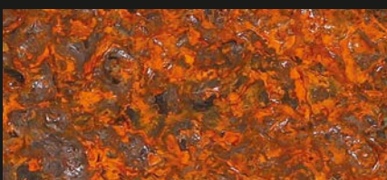
Sin tratamiento de protección contra la corrosión
